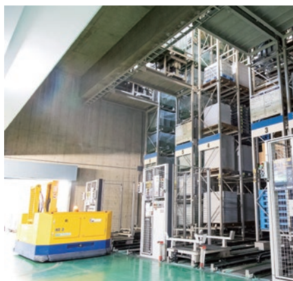
1990年の現工場建設時に導入したAGV(写真左下、無人搬送台車)と仕掛品自動倉庫
